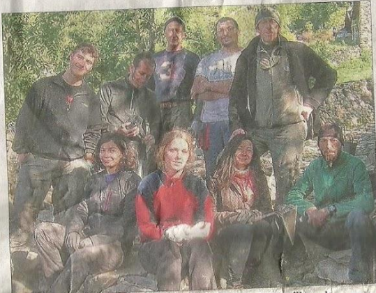
Termignon restauration de la route du sel, par les Murailleurs de Provence et l'association "Jeunesse et reconstruction".
